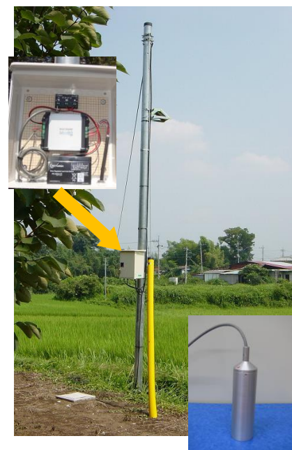
ソーラーパネル・増幅器(地震計)
